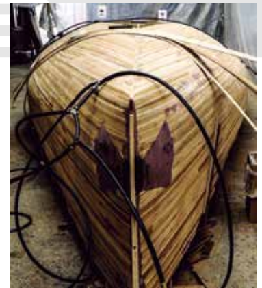
ボトムの一部を除き、ほぼストリップが積み上がっている状態。外板はこの後、角度を変えて薄いレッドシダー二層+マホガニー一層を積層する
